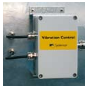
Puszka przyłączeniowa – Kontrola wibracji
