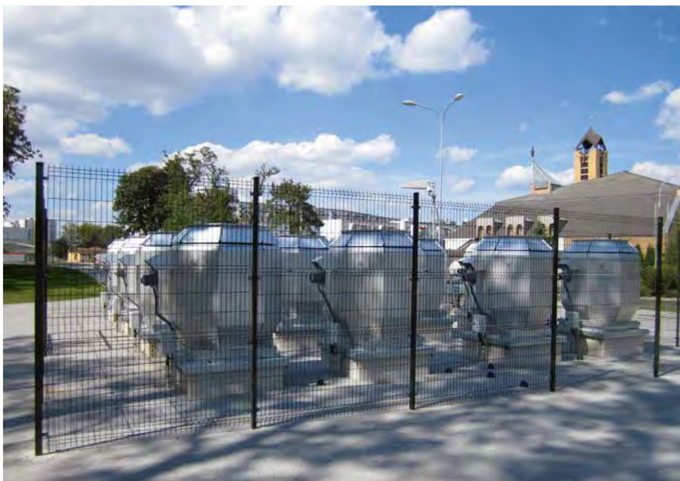
Oddymianie tunelu tramwajowego w Poznaniu – 16 szt. DVV 1000
