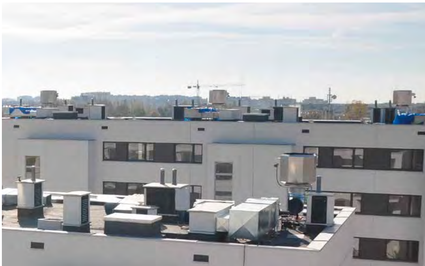
Instalacja wentylatorów oddymiających DVV na dachu
