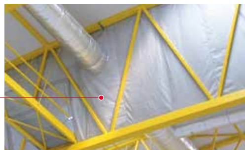
stałe kurtyny z tkaniny z przejściami instalacyjnymi
