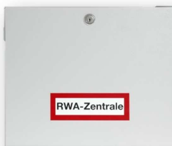
Rys. 44. Centrala systemu oddymiania RWZ 1b.
