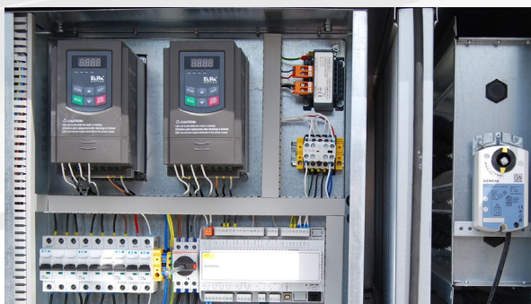
Zabudowane elementy automatyki oraz skrzynka zasilająco-sterująca.
